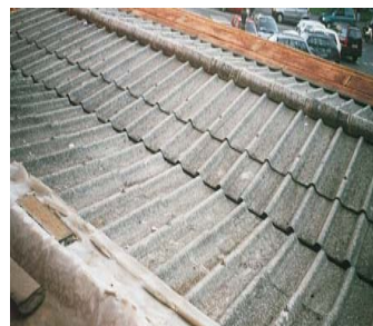
COPERTURA IN ETERNIT
